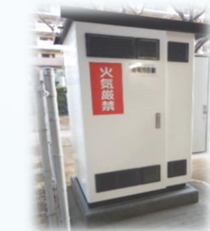
非常時利用出来る蓄電池を設置
